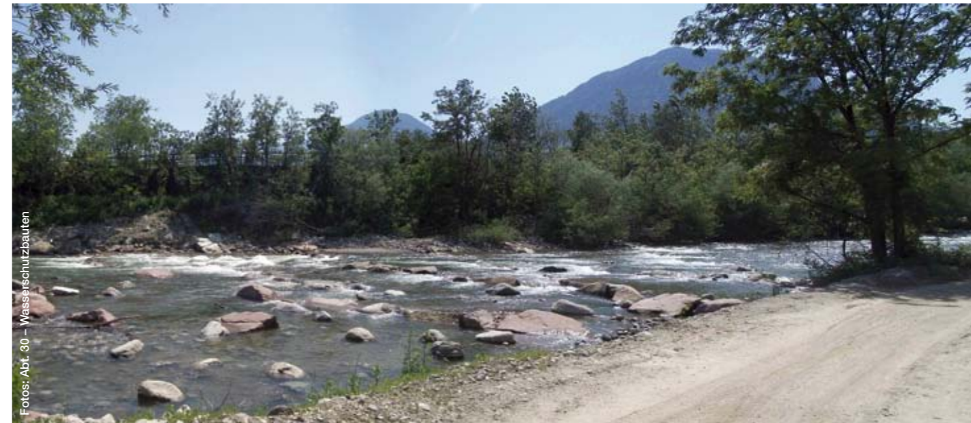
Abb. 2 und 3: Umbau der Sperren in der Falschauer bei Lana, um die Fischwanderung zu ermöglichen: Wiederherstellen der Durchgängigkeit mittels aufgelöster Rampe (oben) und seitlicher L-Rampe (unten).
